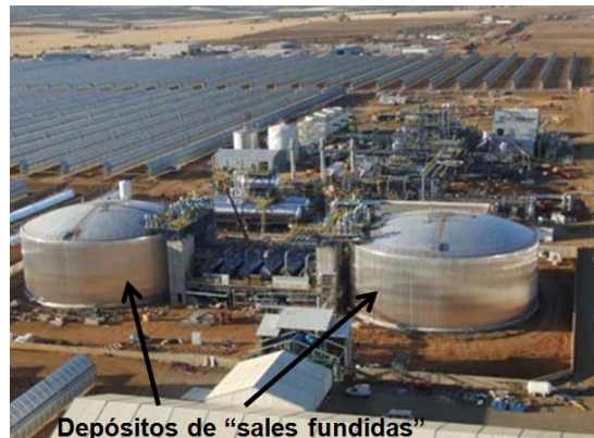
Figura 62 Acumuladores térmicos de la central térmica Extresol-1 en Torre de Miguel Sesmero, Extremadura. (ACS)
