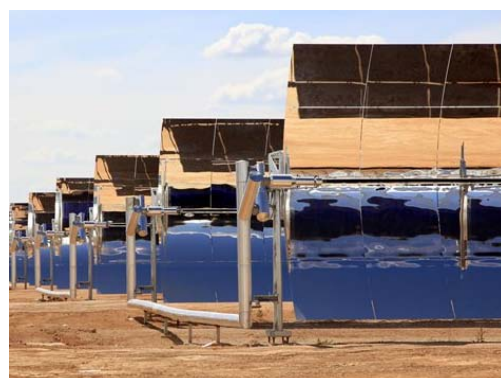
Figura 61 Campo Solar de la Central Termosolar de Puertolano (Iberdrola Renovables)
