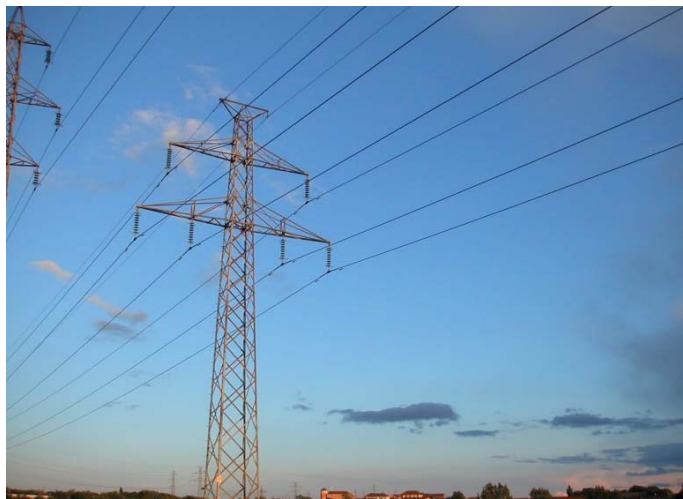
Figura 3.- Torre de Alta Tensión. El tamaño de la torre varía dependiendo del voltaje requerido y la capacidad de la línea.
